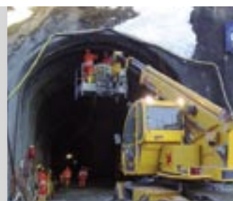
Elektrárň Nant de Drance, Švajčiarsko
