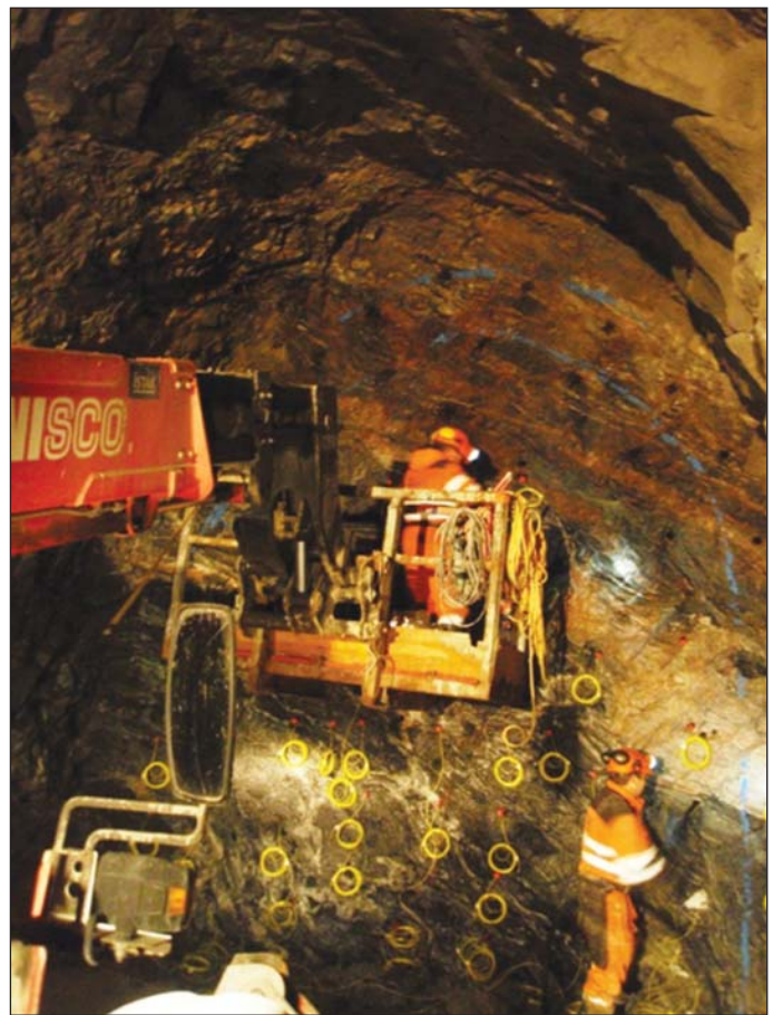
Obr. 10 Nabíjanie vývrvtov v čelbe prepojovacieho tunela Fig. 10 Charging the blast holes in the interconnecting tunnel face
