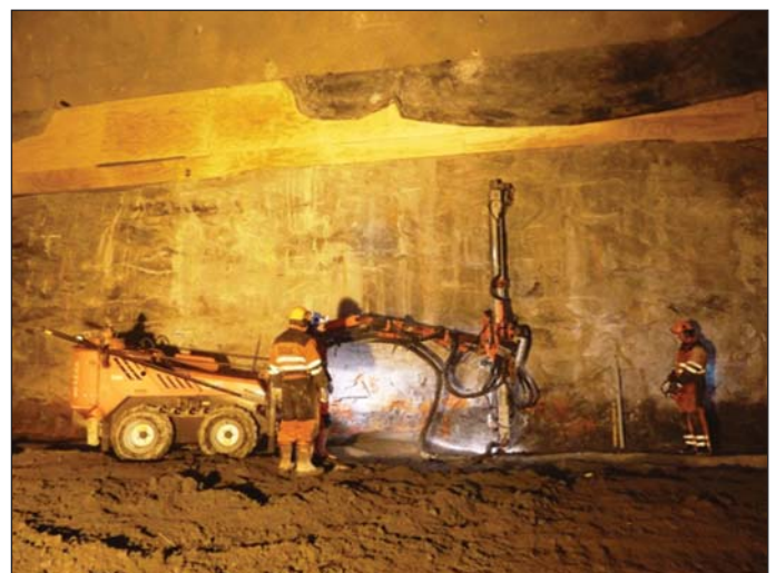
Obr. 7 Druhá etapa razenia podzemnej strojovne Fig. 7 The second stage of the underground powerhouse excavation
